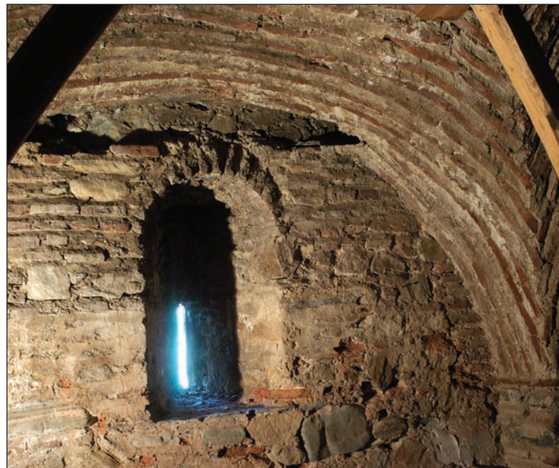
Φωτ.60 Ίχνος εντός της τοικοποιίας προϋπάρχουσας ξύλινης περιμετρικής μάντωσης, που έχει αποσαθρωθεί.
