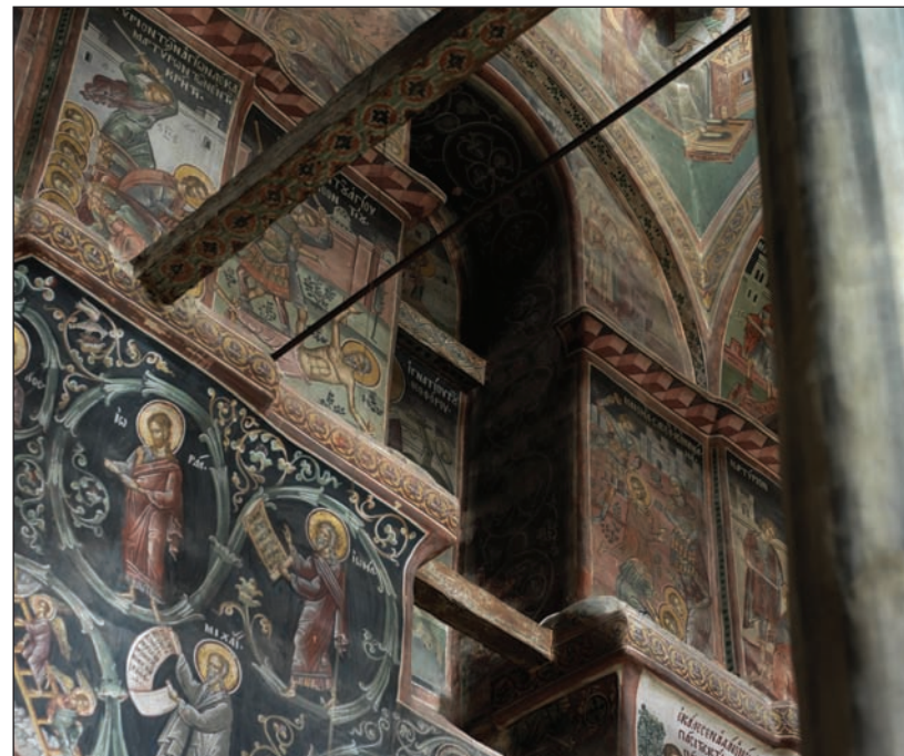
Φωτ.42 Λεπτομέρεια της φωτ.41, στην οποία διακρίνεται η διαφορά των επιπέδων που ανήκουν οι εντός της κόγχης του παραθύρου ξύλινες ενισχύσεις.
