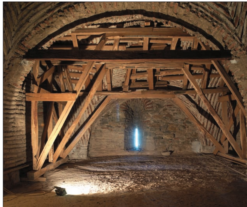
Φωτ.62 Πρόχειρη υποστήλωση της ρηγματωμένης θολοδομίας γωνιακού κόρου του Υπερώου.
