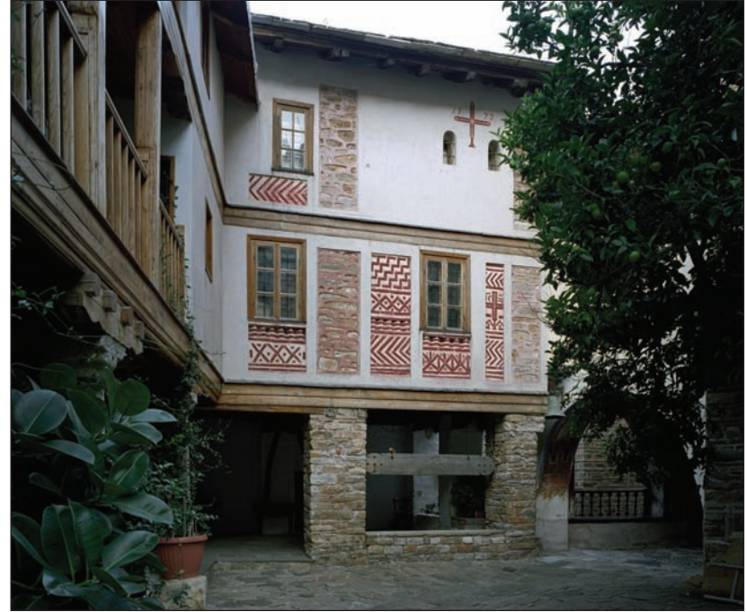
Φωτ.18 Εσωτερική άποψη της δυτικής κόρδας με τα αποκαλυφθέντα τμήματα κεραμοπλαστικού διακόσμου διαφόρων τύπων.
