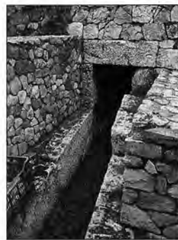
Εικ. 14: Ο αγωγός αποχέτευσης των υδάτων έξω από την σταδή.
