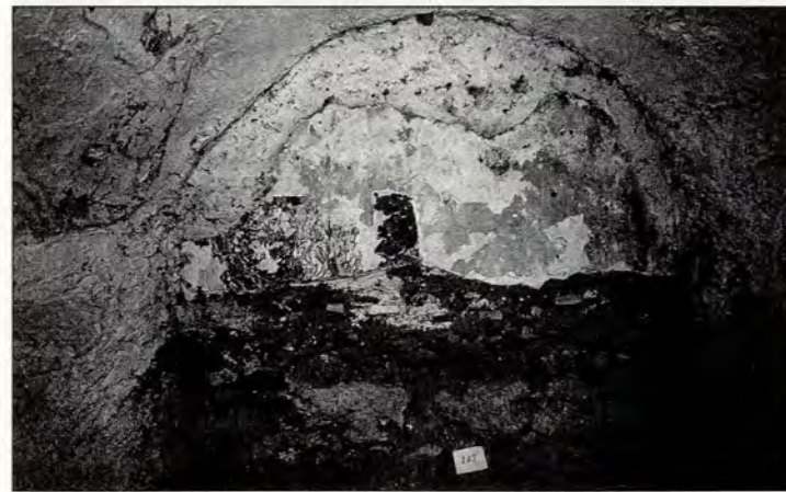
Εικ. 17 Διάβρωση αρμοτοχημάτων και επιχρισμάτων στο εσωτερικό των κελιών.
