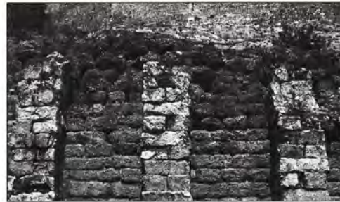
Εικ. 18: Κατεστραμμένο τμήμα της τοξοστασίας. Διακρίνεται η έντονη διάβρωση του ηλατινοκροκατοληγού πεπρήματος.
