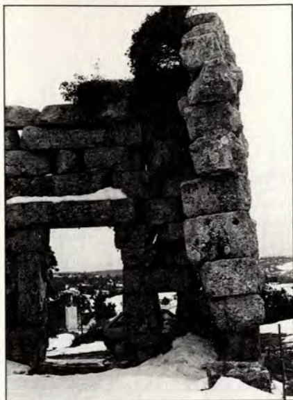
Εικ. 17: Απόκλιση του βορειοδυτικού τοίχου.
