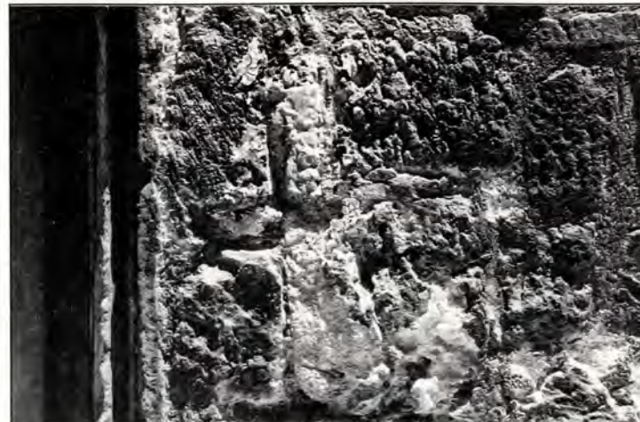
Εικ. 21: Ατμοσφαιρικές επικαθίσεις με ανάπτυξη μαύρης επιφανειακής κρούστας με εξέλιξη του φαινομένου, διάβρωση των υποκειμένων στρωμάτων και απώλεια υλικού.
