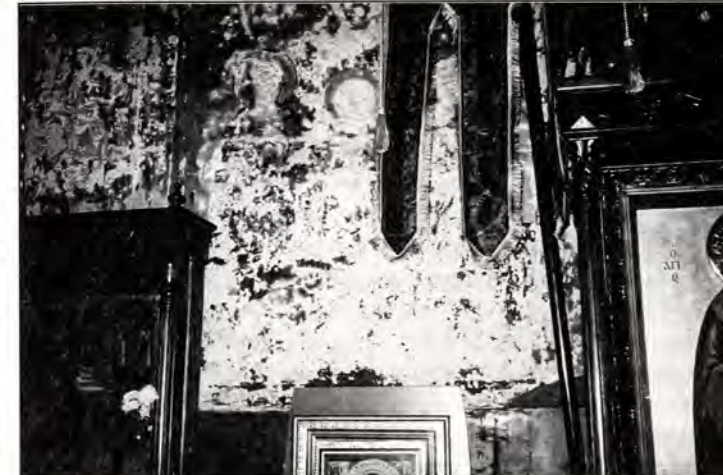
Εικ. 22: Απώλεια χρωματικής επιφάνειας και επικρίσματος λόγω ανερχόμενης υγρασίας, μεταφοράς διαλυτών αλάτων και ανάπτυξη βιοτοξικών ρύπων.
