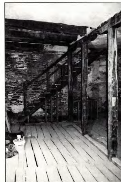
Εικ. 7: Εσωτερική άποψη του 4ου ορόφου. Διακρίνεται το σύστημα φερόντων υποστηλωμάτων του πατώματος.
