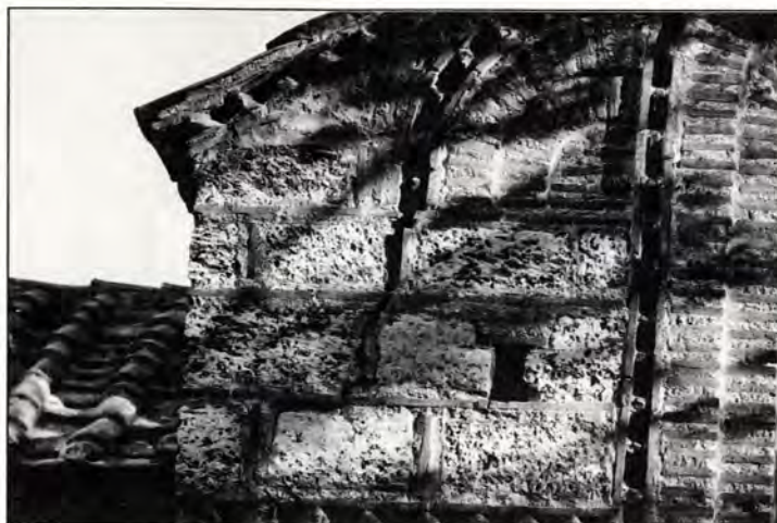
Εικ. 18: Ρήγμα στη δυτική όψη.
