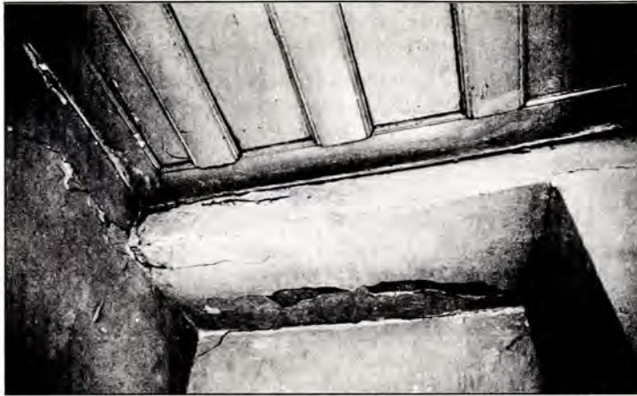
Εικ.21: Λεπτομέρεια οροφής και διαζώματος (β' φάση) από οπτημένο σκυρόδεμα, σε μέτρια κατάσταση λόγω τοπικής διαβρωσης.
