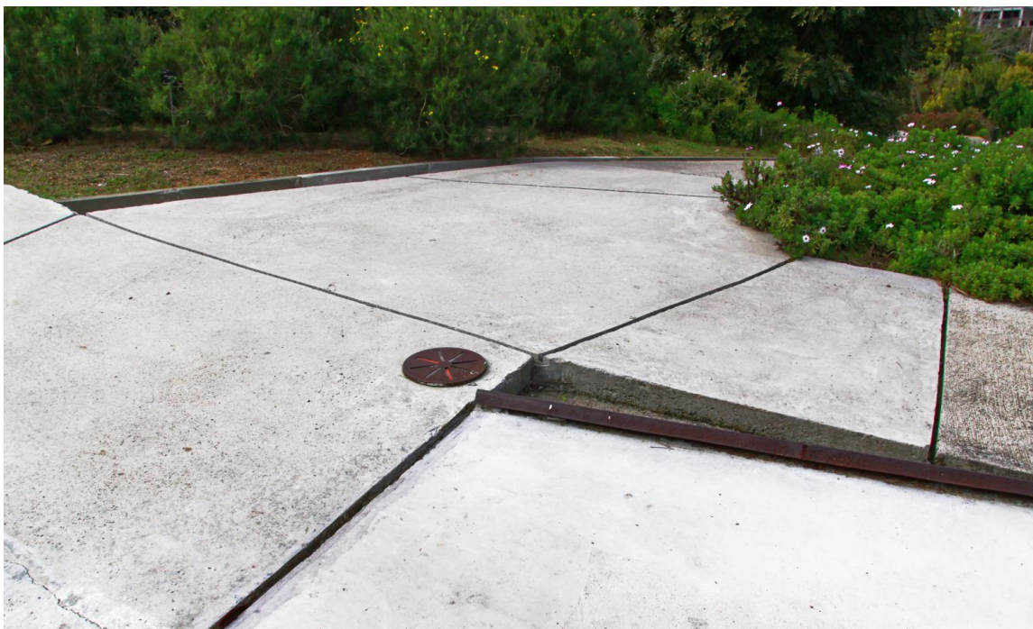
Εικόνα 6.94 Δαπεδοστρώσεις στον Βοτανικό Κήπο της Βαρκελώνης (JBB) από ελαφρά οπλισμένο σκυρόδεμα με διαφορετικές επιφανειακές επεξεργασίες στην τελική του όψη και ενσωματωμένα λειτουργικά στοιχεία από Corten. Οι αρμοί, εκτός από κατασκευαστική ανάγκη, έχουν οργανωθεί με σχεδιαστική πρόθεση. Αρχιτέκτονες Carlos Ferrater και Josep Lluís Canosa, Βαρκελώνη, Ισπανία 1999.
