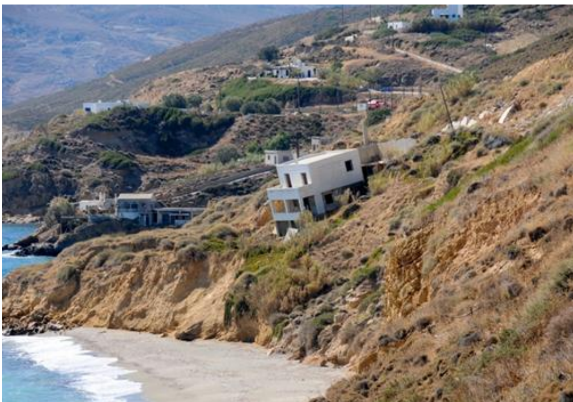
Εικόνα 1.44 Κτίριο στη Σκύρο. Αστοχία υποθεμελίωσης από προφανή υποχώρηση του εδάφους. Αξίζει να παρατηρηθεί ότι το κτίριο διατηρεί την ακεραιότητά του από άποψη αντοχής και επίσης ότι έχει επαρκή ακαμψία διατηρώντας απαραμόρφωτη τη γεωμετρία του. Η λήψη της φωτογραφίας έγινε από την Ελένη Αλεξάνδρου.
