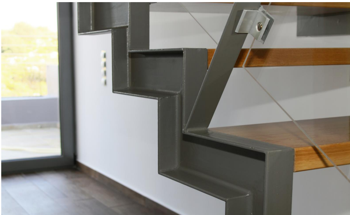
Εικόνες 6.56 Βαθμιδοφόρος σκάλας από κομμένες διατομές UNP και ηλεκτροσυγκολλημένες με συνεχή ραφή.
