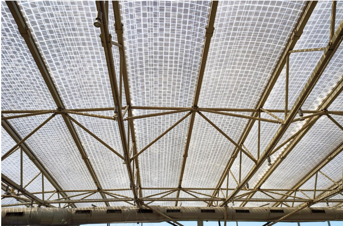
Εικόνα 3.26 Κάλυψη χώρου με φουσκωτές συνθετικές μεμβράνες. Οι εκτυπώσεις στις μεμβράνες λειτουργούν για τον έλεγχο σκίασης του χώρου. Οι μεμβράνες είναι στερεωμένες σε σύστημα μεταλλικών δικτυωμάτων.
