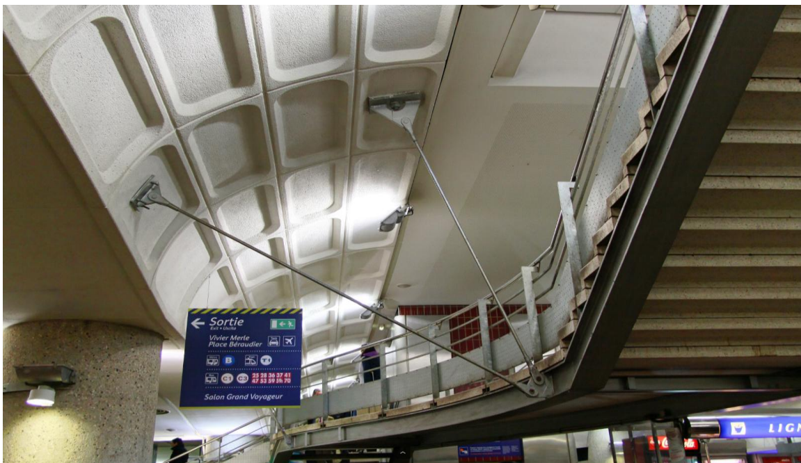
Εικόνα 6.82 Μεταλλικός διάδρομος αναρτημένος με χαλύβδινους ελκυστήρες στην οροφή από σκυρόδεμα. Σταθμός TGV της Λυών.
