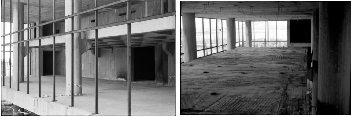
Εικόνες 3.37, 3.38 Φορέας από οπλισμένο σκυρόδεμα. Διακρίνονται χαρακτηριστικά οι «βραχείς πρόβολοι» που στηρίζουν σε απόσταση τη φαντωματική πλάκα του παταριού.
