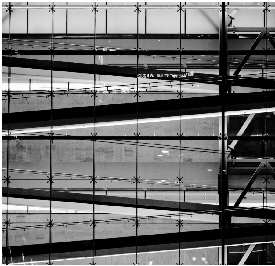
Εικόνα 4.20 Επέκταση υπάρχοντος κτιρίου της Εθνικής Πινακοθήκης. Υαλοστάσιο στην όψη με τις ράμπες κατακόρυφης κίνησης. Αρχιτεκτονικά Γραμματόπουλος-Πανουσάκης και Δ. Βασιλόπουλος, στατικά Λιόντος, Αθήνα 2019.
