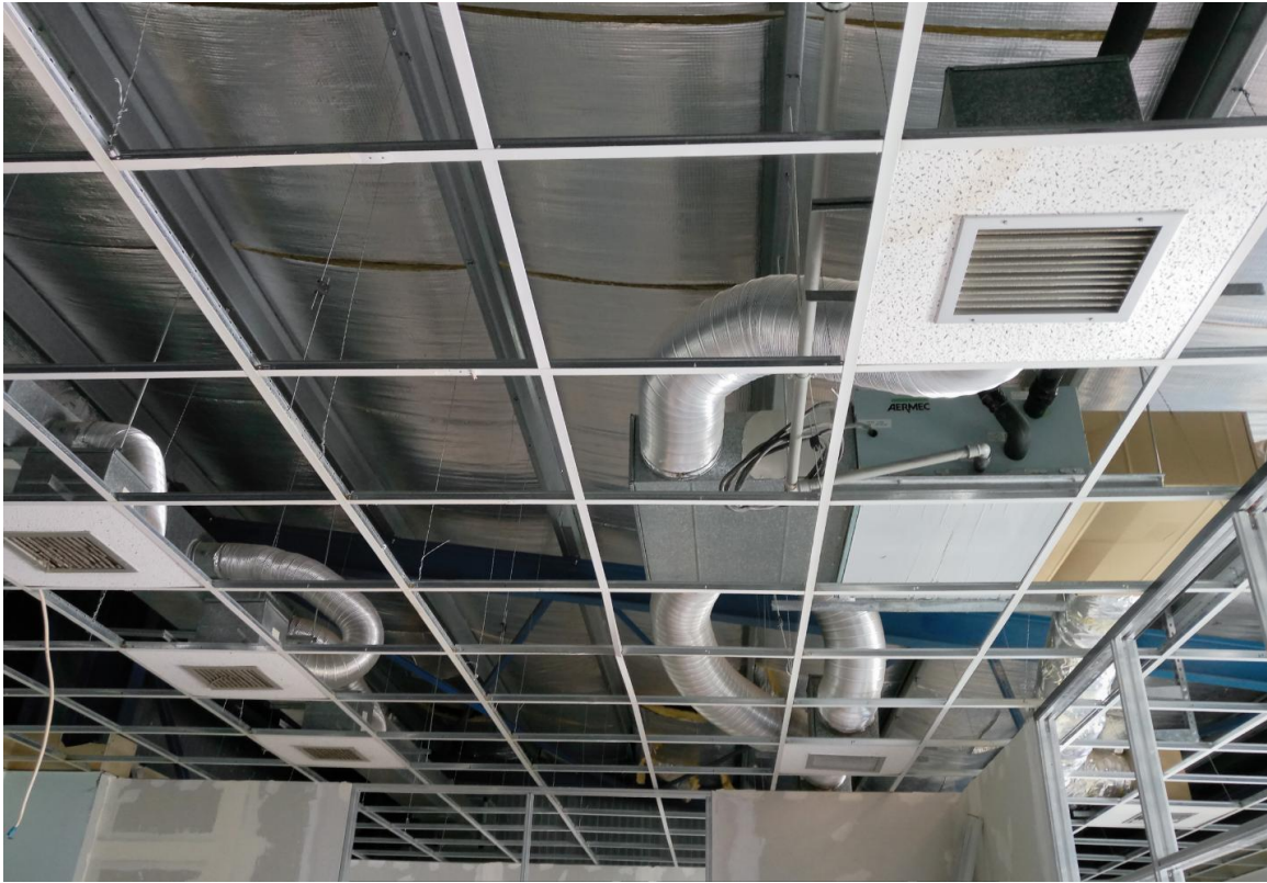
Εικόνα 6.90 Ψευδοροφή από πλάκες ορυκτών ινών. Διακρίνεται ο σκελετός ανάρτησης και οι ήδη τοποθετημένες πλάκες με στόμια εξαερισμού των κλιματιστικών μονάδων.
