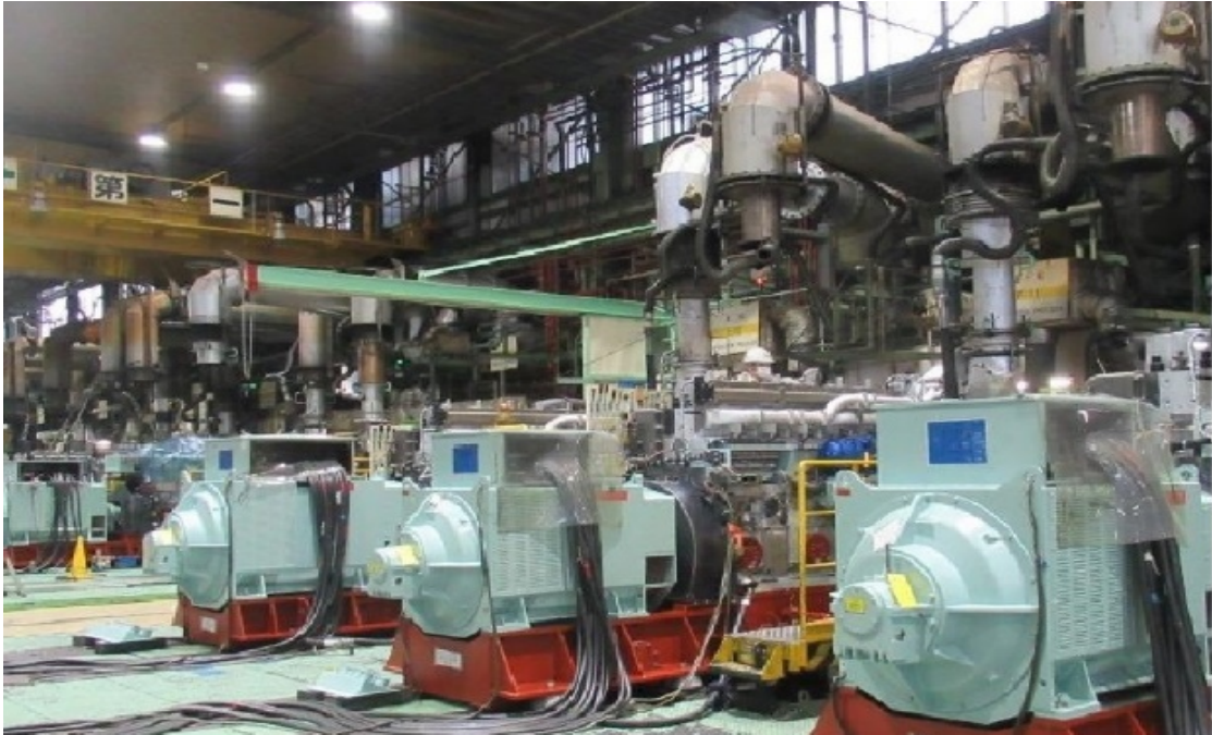
Εικ. 3.63 Δοκιμή παράλληλης λειτουργίας ηλεκτρογεννητριών στο εργοστάσιο του κατασκευαστή.
