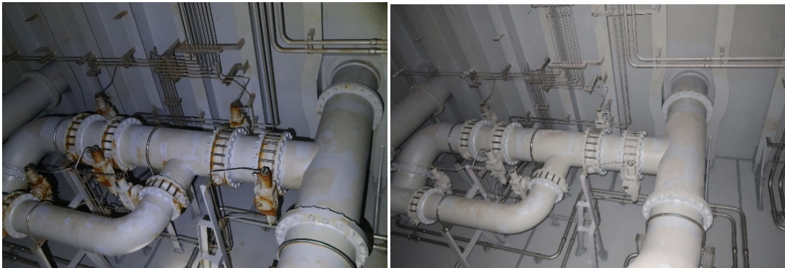
Εικ. 3.113 Τοπικές οξειδώσεις σε δεξαμενές φορτίου.
