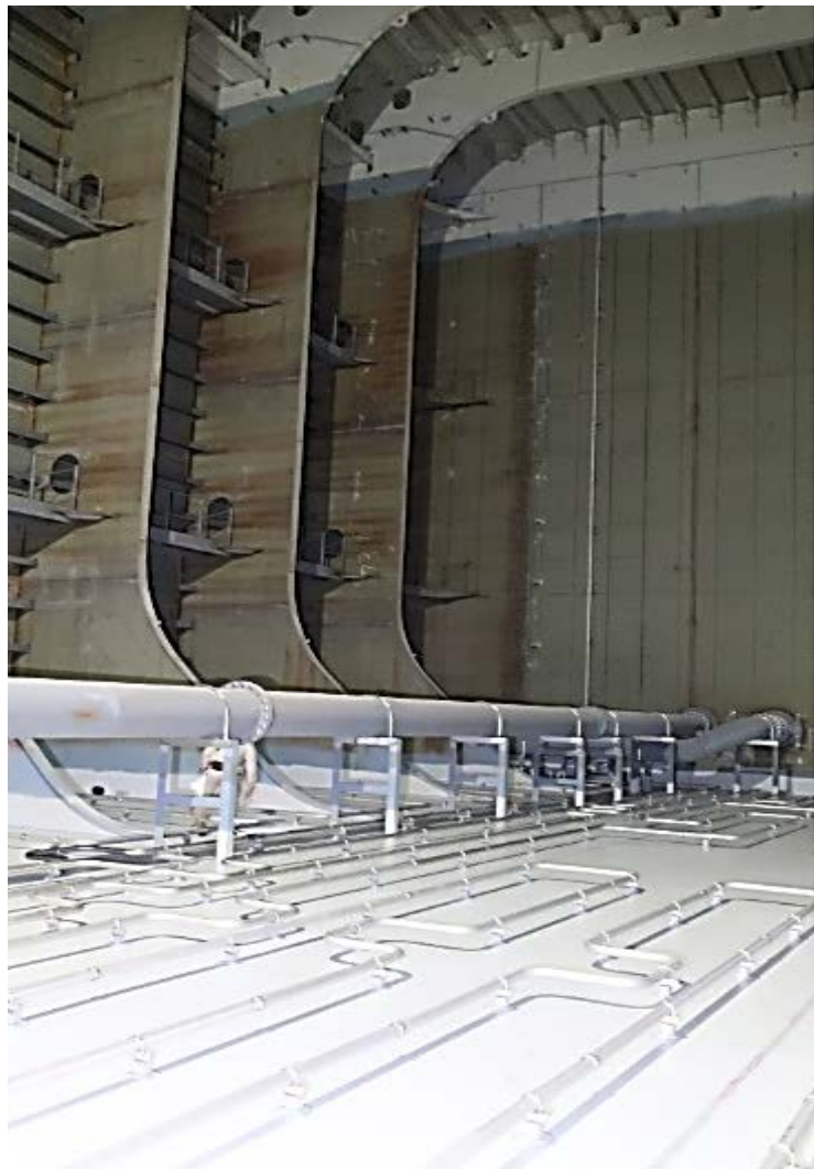
Εικ. 3.43 Δεξαμενές αργού πετρελαίου με άβαφη την περιμετρική επιφάνεια.
