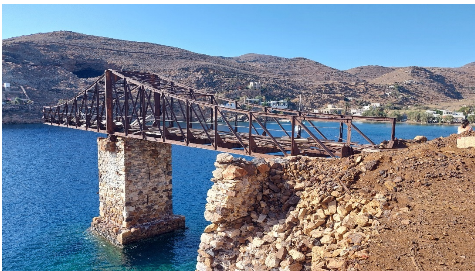
Εικόνα 9-15. Γενική άποψη της σκάλας φόρτωσης του Μεγάλου Λειβαδιού και κατάρρευση τμημάτων του παράκτιου αναλημματικού τοίχου. Φωτό: Ερευνητική Ομάδα, Μάιος 2024.
