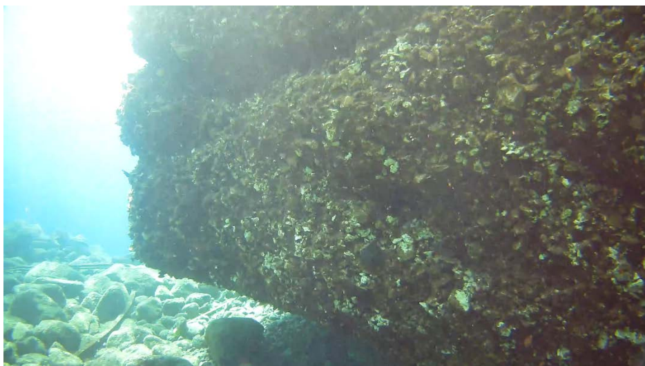
Εικόνα 9-39. Σκάλα φόρτωσης Μεγάλου Λειβαδιού. Θεμέλιο του βάθρου. Διακρίνεται η υποσκαφή-σπηλαίωση. Φωτό: ARGO NAVIS - ΕΜΠ, Μάιος 2024.
