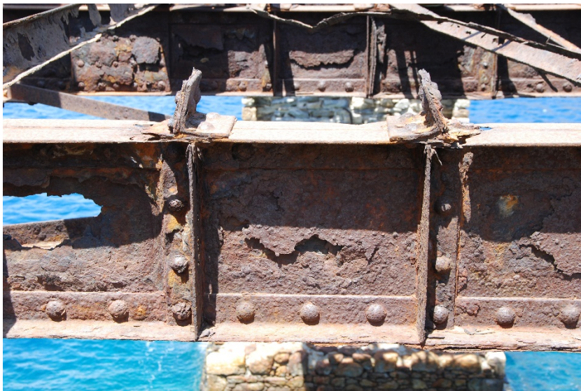
Εικόνα 9-31. Σκάλα φόρτωσης Μεγάλου Λειβαδιού. Φαίνεται η διάτρηση μεταλλικών μελών. Φωτό: Ερευνητική Ομάδα, Μάιος 2024.
