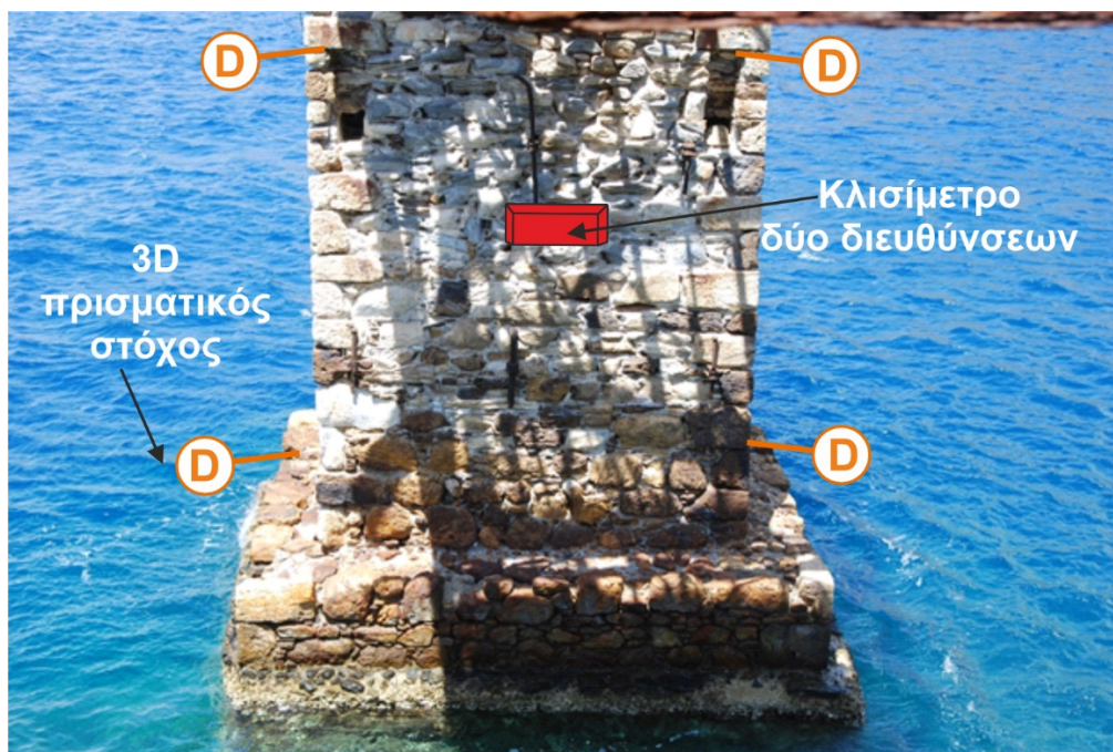
Εικόνα 9-45. Σκάλα φόρτωσης Μεγάλου Λειβαδιού. Ενδεικτική θέση εγκατάστασης κλισιμέτρου δύο διευθύνσεων και 3D πρισματικών στόχων στον πυλώνα . Φωτό: Ερευνητική Ομάδα, Μάιος 2024.
