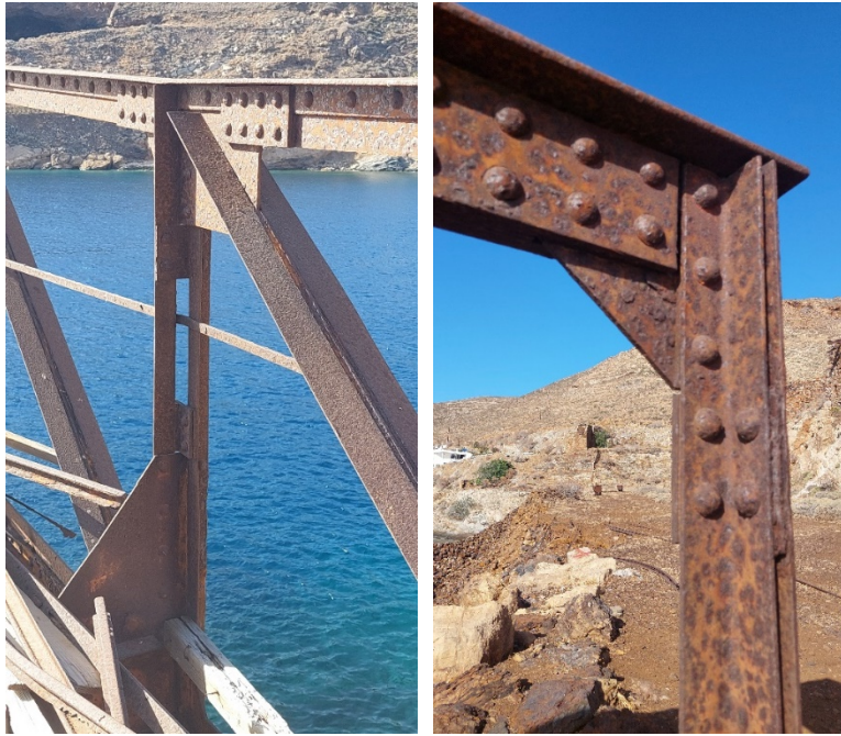
Εικόνα 9-32. Σκάλα φόρτωσης Μεγάλου Λειβαδιού. Λεπτομέρειες ηλωτών συνδέσεων και εικόνα διάβρωσης. Φωτό: Ερευνητική Ομάδα, Μάιος 2024.
