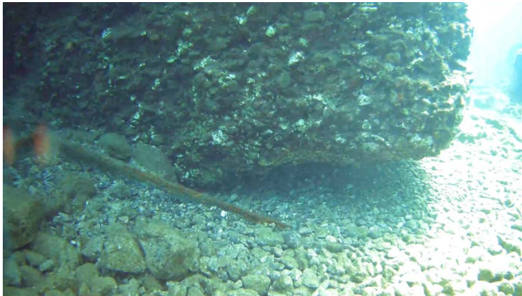
Εικόνα 9-35. Σκάλα φόρτωσης Μεγάλου Λειβαδιού. Θεμέλιο του βάθρου. Διακρίνεται η υποσκαφή-σπηλαίωση. Φωτό: ARGO NAVIS - ΕΜΠ, Μάιος 2024.
