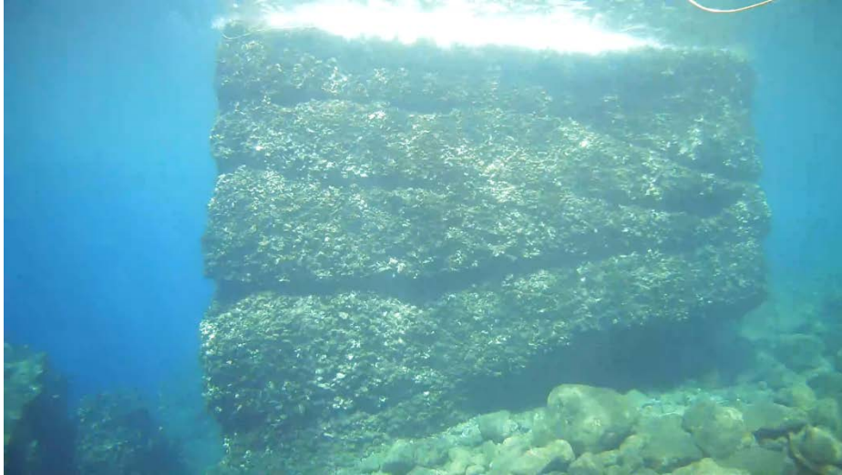
Εικόνα 9-10. Σκάλα φόρτωσης Μεγάλου Λειβαδιού. Θεμέλιο του βάθρου Διακρίνεται η έντονη υποσκαφή του θεμελίου. Φωτό: ARGO NAVIS - ΕΜΠ, Μάιος 2024.
