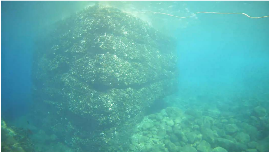
Εικόνα 9-11. Σκάλα φόρτωσης Μεγάλου Λειβαδιού. Θεμέλιο του βάθρου Διακρίνεται η έντονη υποσκαφή του θεμελίου. Φωτό: ARGON NAVIS - ΕΜΠ, Μάιος 2024.
