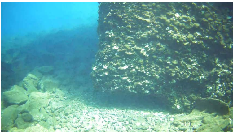
Εικόνα 9-36. Σκάλα φόρτωσης Μεγάλου Λειβαδιού. Θεμέλιο του βάθρου. Διακρίνεται η υποσκαφή-σπηλαίωση. Φωτό: ARGO NAVIS - ΕΜΠ, Μάιος 2024.
