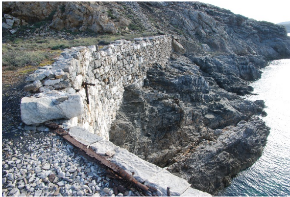
Εικόνα 9-53. Αναλημματικός τοίχος επιπέδου κίνησης βαγονέτων. Φωτό: Ερευνητική Ομάδα ΕΜΠ, 2024.
