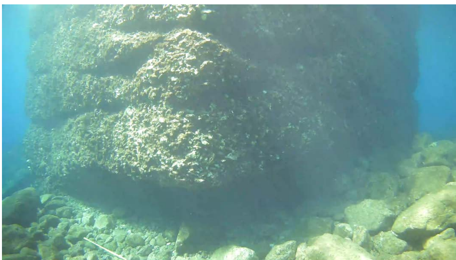
Εικόνα 9-37. Σκάλα φόρτωσης Μεγάλου Λειβαδιού. Θεμέλιο του βάθρου. Διακρίνεται η υποσκαφή-σπηλαίωση. Φωτό: ARGO NAVIS - ΕΜΠ, Μάιος 2024.
