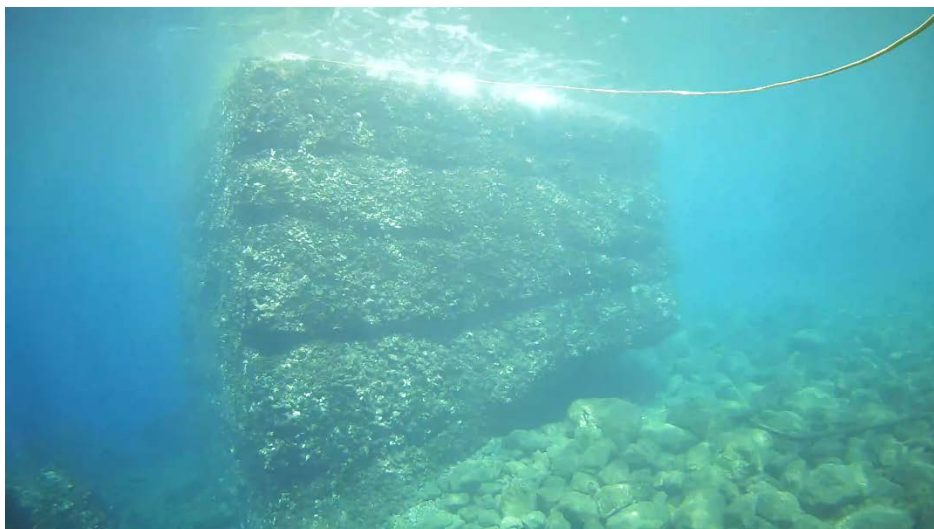
Εικόνα 9-38. Σκάλα φόρτωσης Μεγάλου Λειβαδιού. Θεμέλιο του βάθρου. Διακρίνεται η υποσκαφή-σπηλαίωση. Φωτό: ARGO NAVIS - ΕΜΠ, Μάιος 2024.
